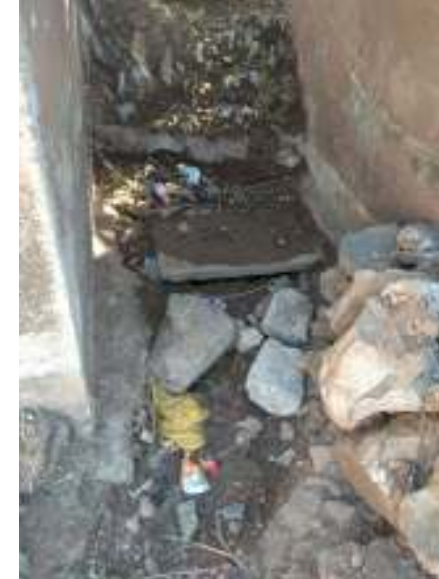
Imagen N° 39: Buzón de desagüe colapsado por acumulación de residuos sólidos.
