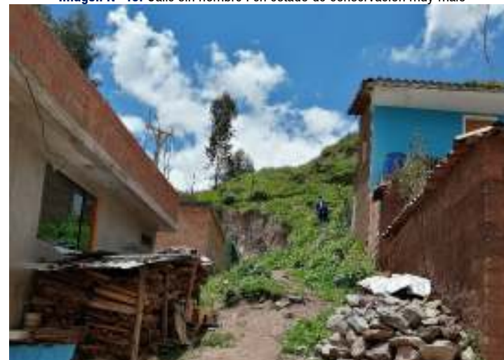
Imagen N° 46: Calle sin nombre I en estado de conservación muy malo
