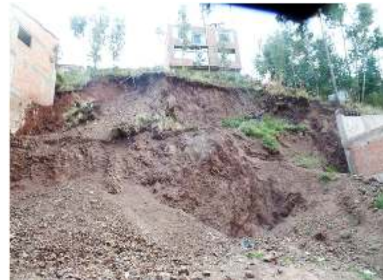
Imagen N° 4: Vista de corte de Talud donde se observa el basamento rocoso conformado por areniscas cuarzo feldespáticas y lutitas de la formación Kayra.
