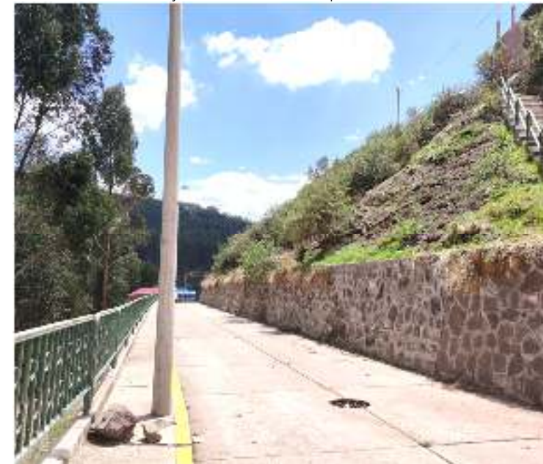
Imagen N° 68: Poste de alumbrado público instalado en la mitad de la acera, disminuyendo y obstaculizando el tránsito peatonal
