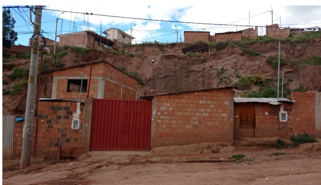
Foto 03: Vista de viviendas residenciales que se encuentra ubicadas muy cerca del pie del talud y otras viviendas que se encuentran en la corona del talud.
