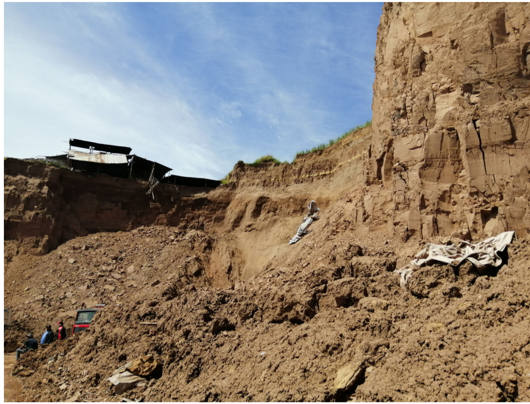
Foto 02: Vista de una unidad productora demasiado cerca de la corona del talud de extracción.
