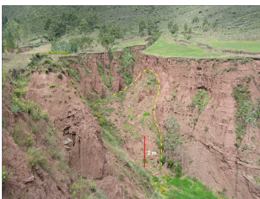
Foto 05. Talud natural con pendientes mayores a 37°, altura aprox. de 10 m, con presencia de grietas, se observa material de suelo caído con espesor de 2 m.
