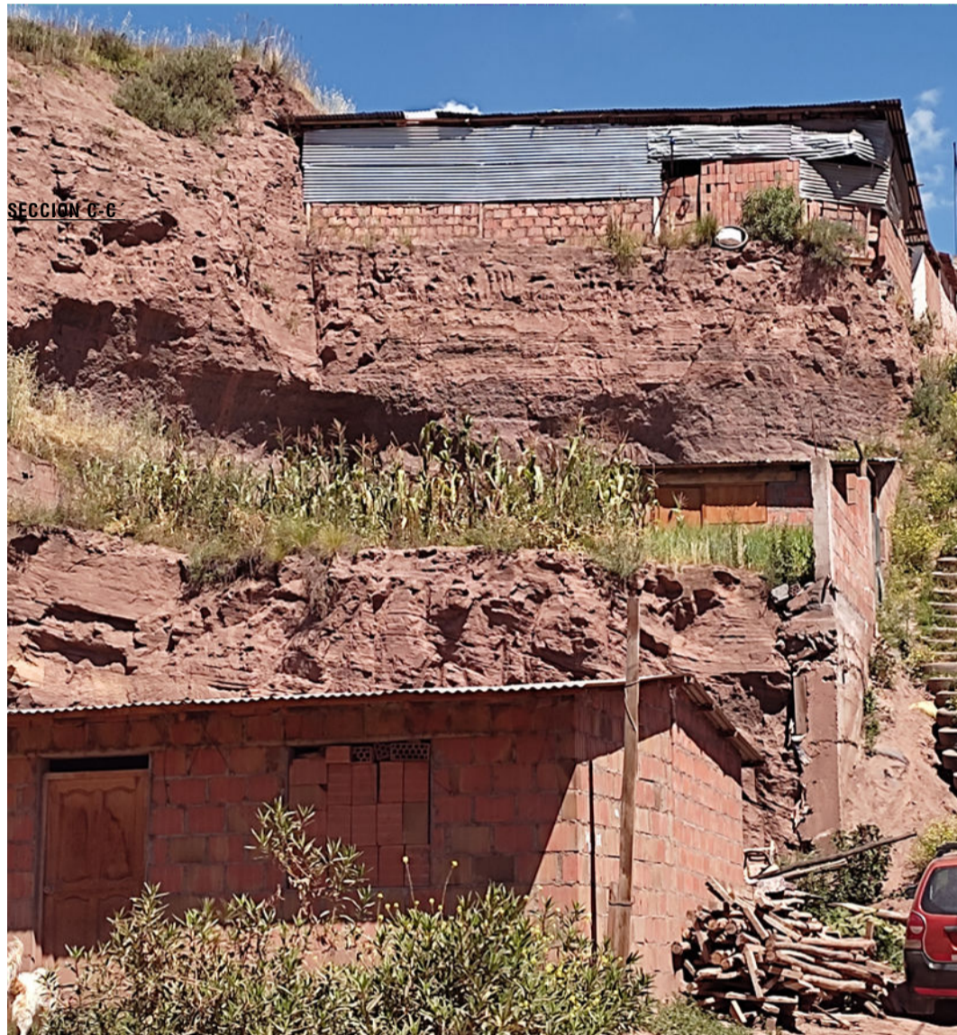
Foto 03. Talud con pendiente mayor a 37°, corte de material sin asentamiento técnico presencia de grietas, edificaciones sobre estos taludes.
