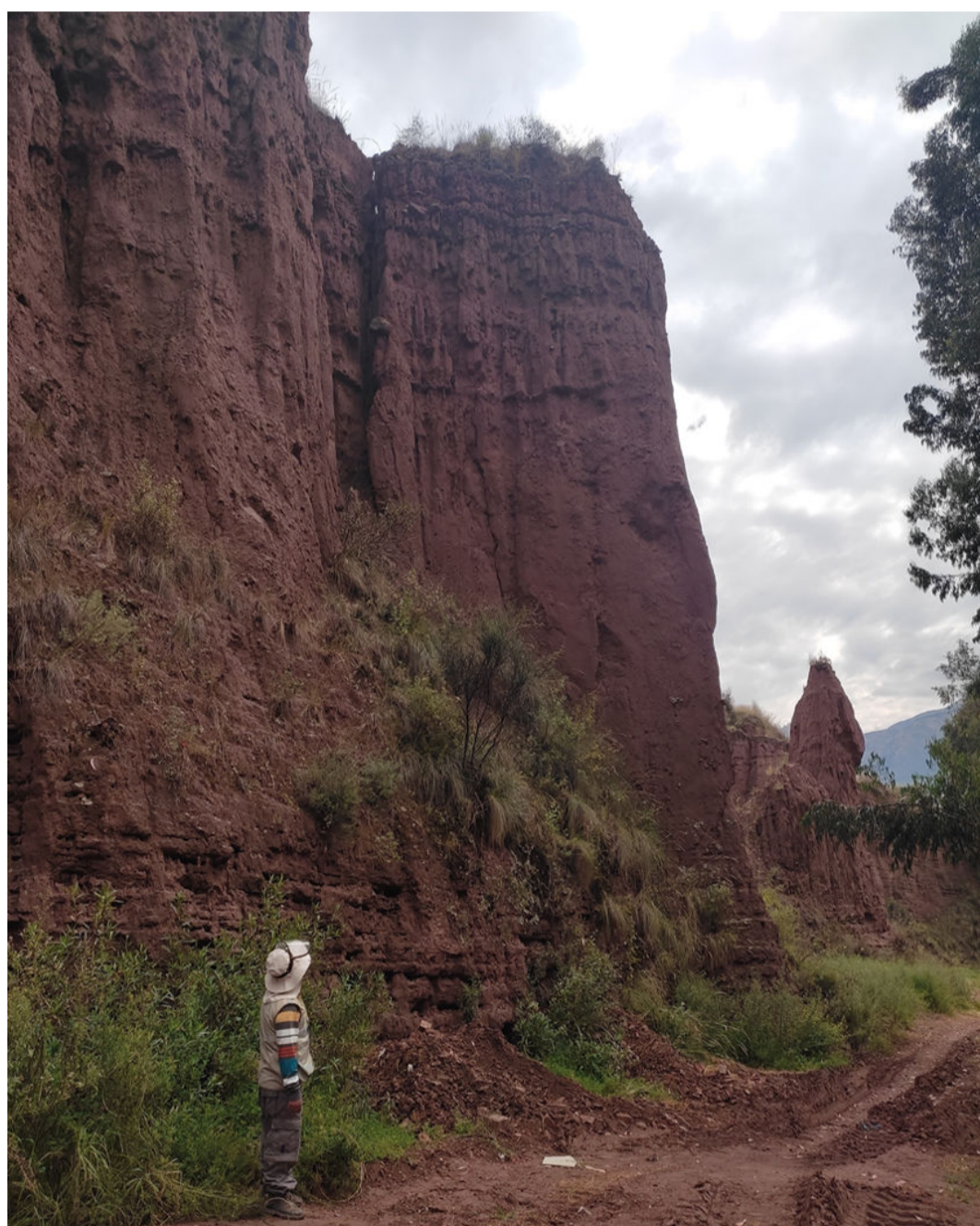
Foto 04. Talud natural con pendientes mayores a 37°, altura aprox. de 6 m, con presencia de grietas.
