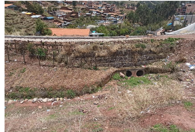
Imagen N° 49: Fotografía de acumulación de residuos sólidos en el cauce del riachuelo, generando estancamiento del agua
