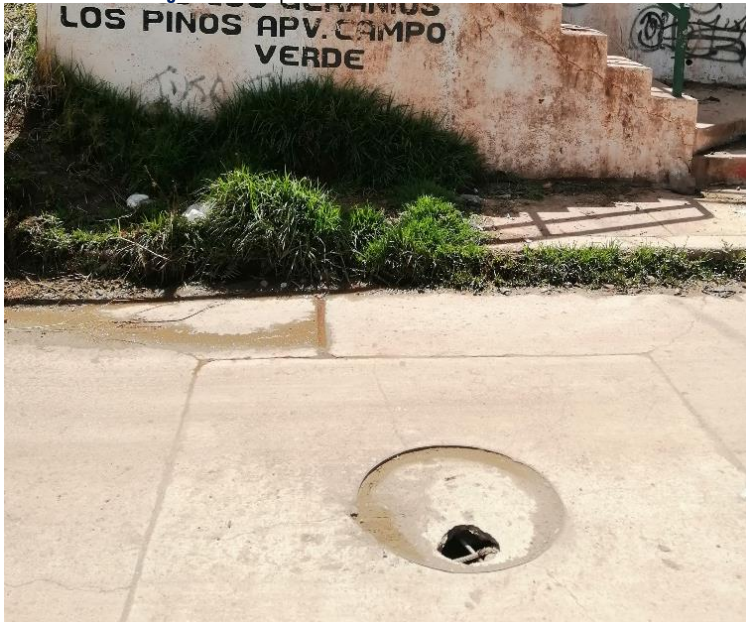
Imagen N° 68: Tapa de buzón deteriorado en calle La Vitoria
