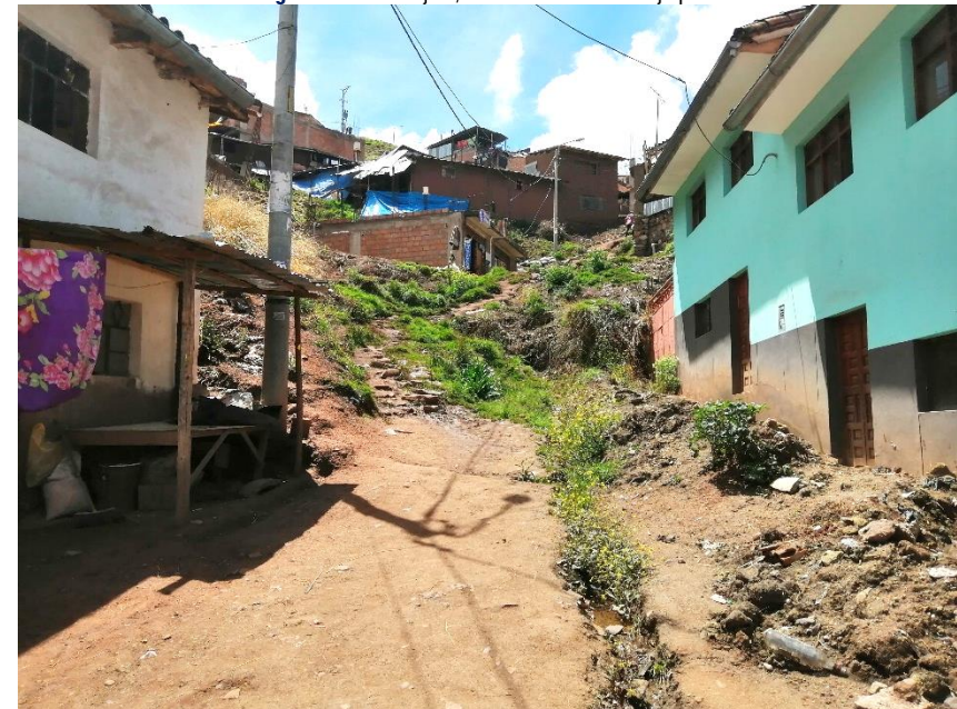
Imagen N° 74: Pasaje S/N 13 carece de drenaje pluvial
