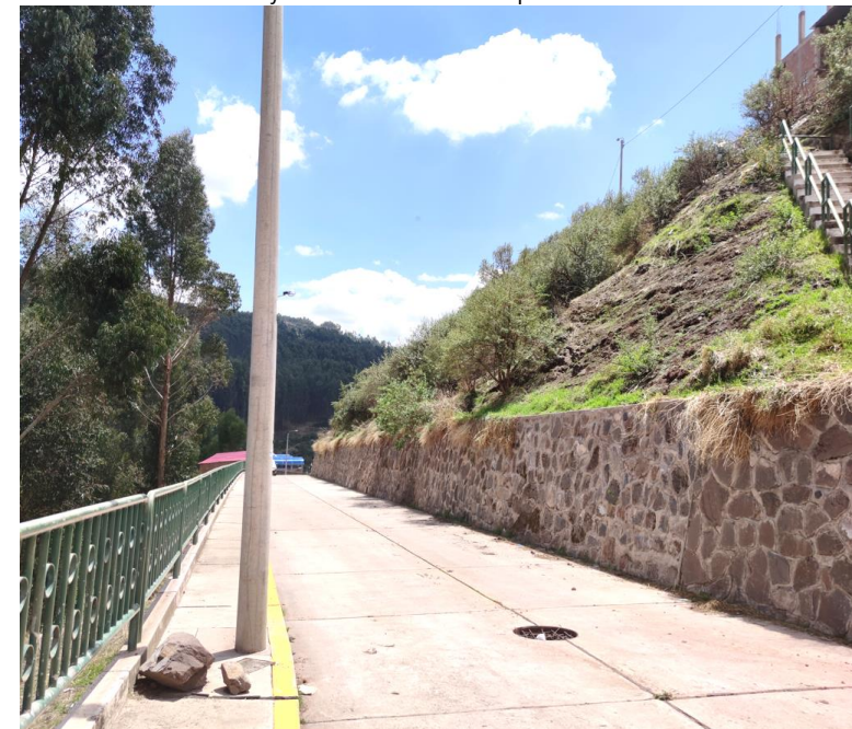
Imagen N° 68: Poste de alumbrado público instalado en la mitad de la acera, disminuyendo y obstaculizando el tránsito peatonal
