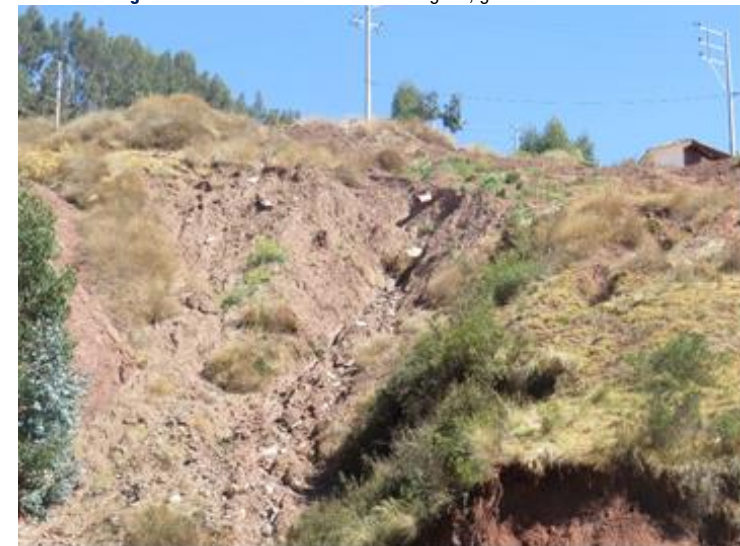
Imagen N° 40: Punto de vertimiento de aguas, generando una cárcava
