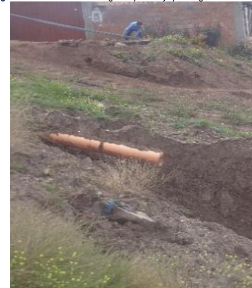
Imagen N° 58: Tubería de desagüe expuesta y que ha generado una cárcava
